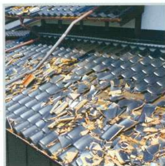
脱落した瓦による二次被害
