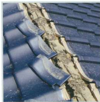
半端瓦の無緊結による脱落
